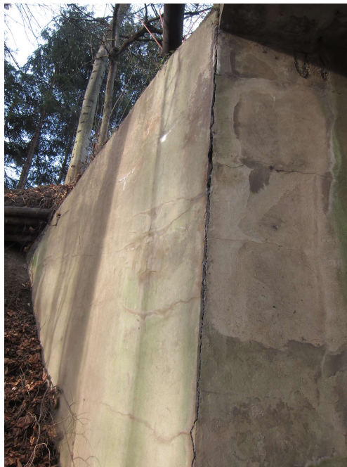
Čelo nátoky a rozpadající se římsy
