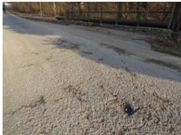
Trhliny a výtluk ve vozovce před OP1.
