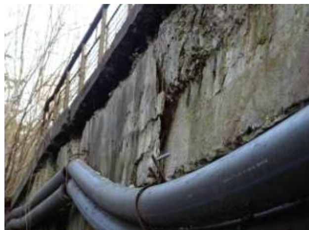
Detail foto vedle – rozpad povrchových vrstev betonu.
