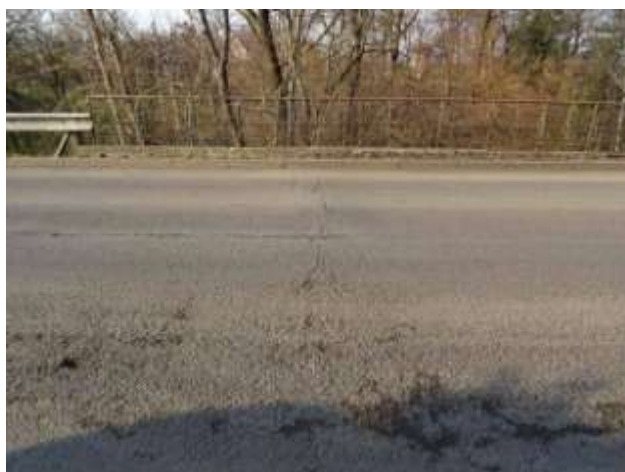
Příčné trhliny nad OP1.
