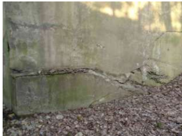
Detail spodní části křídla K2P. Štěrkové hnízdo v betonu, odpadlé omítky.
