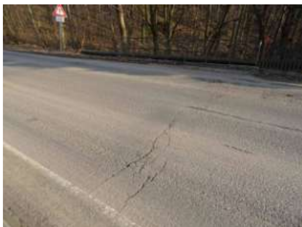
Příčné trhliny nad OP1.
