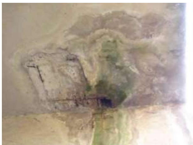
Detail zatékání na podhled NK u levého prostupu odvodňovače před OP1.
