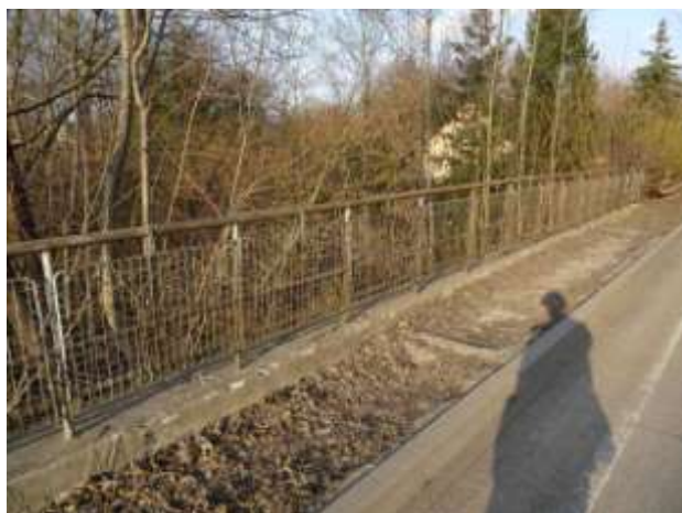
Levý chodník – chybí konstrukce chodníku.
