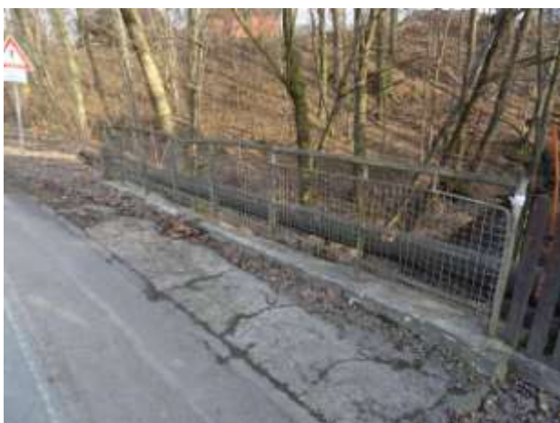
Pravý chodník, trhliny v betonu, zdeformované zábradlí.
