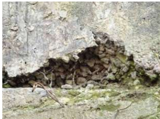
Detail foto vedle – šterkové hnízdo v betonu.
