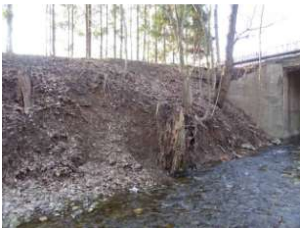
Levý břeh před mostem (u křídla K1P). Strmý neopevňený svah.
