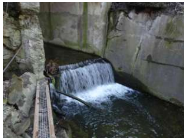
V mostním otvoru je vysoký vodní stupeň.
