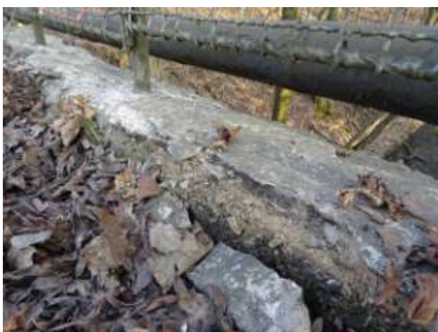
Rozpad betonu římsy pravého chodníku.
