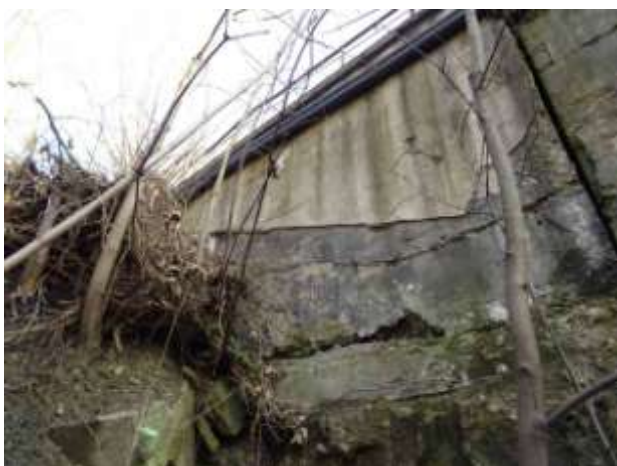
Pracovní spáry betonáže pod horní částí křídla K2L.
