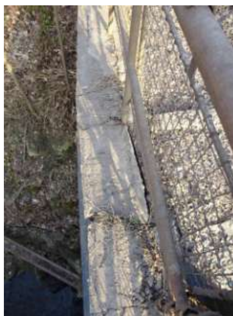
Římsa nad křídlem K2L – vychýlení římsy.
