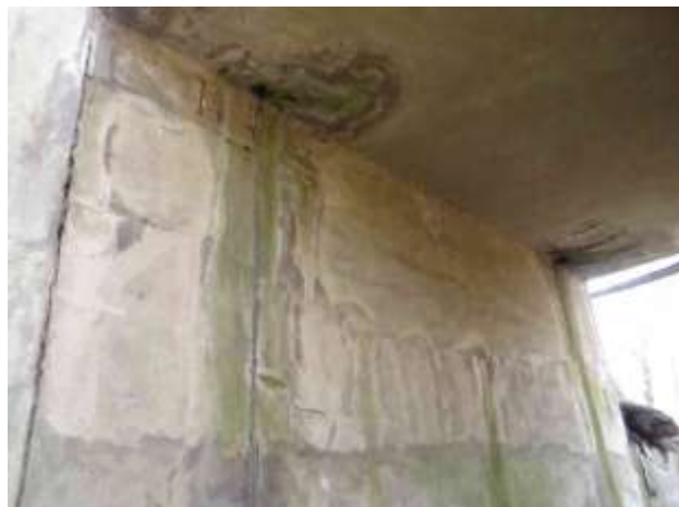
Horní část OP1 . Zatékání kolem nefunkčního odvodňovače.
