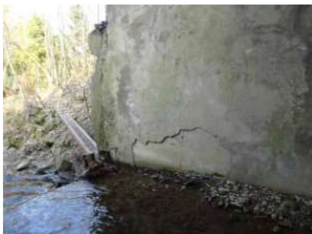
Levé nároží OP2 – opadaná omítka, zvlhlý povrch.
