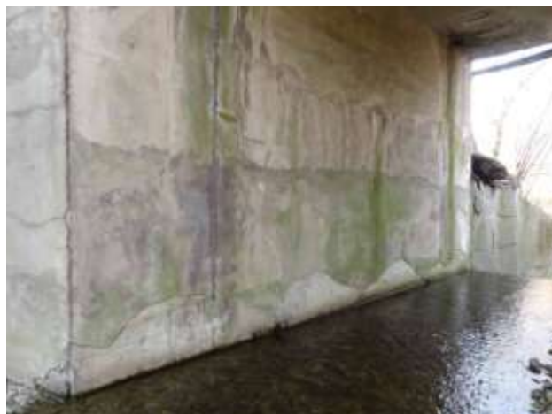
Spodní část OP1. Průsaky v pracovních spárách betonáže, v dolní části opadané omítky.
