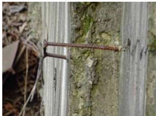
Detail foto vedle. Od instalace je stav náklonu křídla setrvalý.
