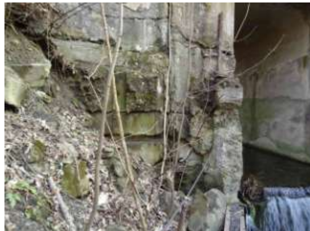
Střední část křídla K2L. Zcela neodborně provedená střední a dolní část křídla.
