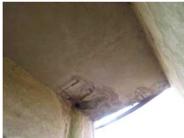
Podhled NK vlevo na výtoku. Zatékání z fasády.
