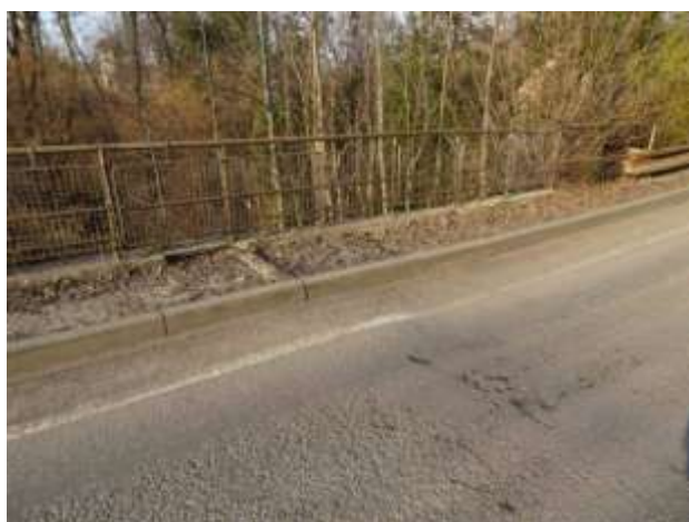
Prosedlá vozovka a obruba vlevo za OP2.
