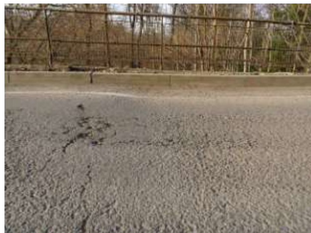
Prosedlá vozovka a obruba vlevo za OP2.
