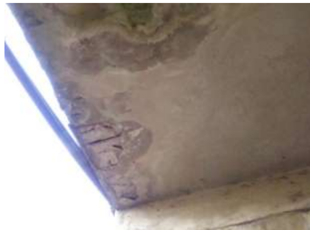
Podhled NK vlevo na výtoku u OP2. Zatékání z fasády, obnažená výztuž.
