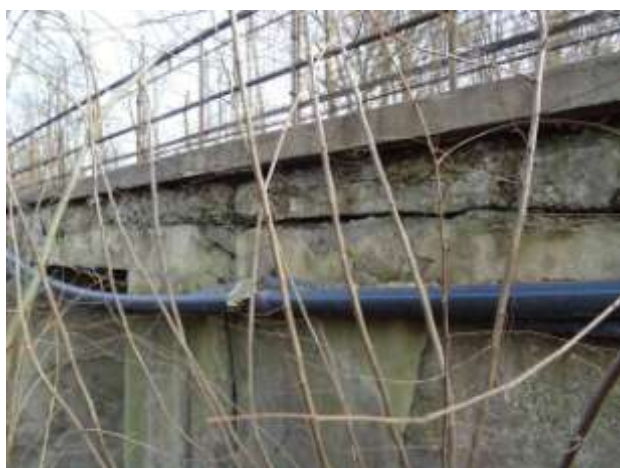
Křídlo K1L – uvolněný beton horní části křídla pod římsou.
