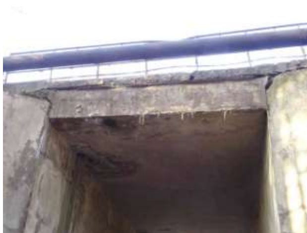
Pravá fasáda NK – zatékání a tvorba krápníků.
