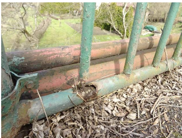
Prokorodované dolní madlo levého zábradlí
