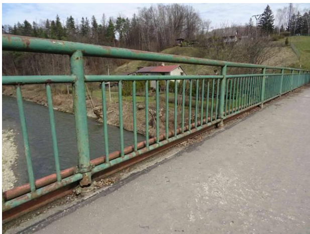
Levé zábradlí – urezlý sloupek v kotvení.
