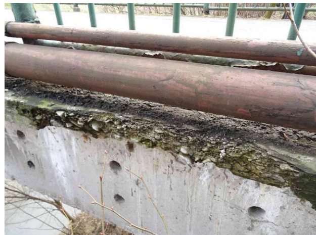
Rozpad betonu levé římsy v poli 1
