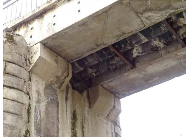
Úložné konzoly podpěry P3 v poli 3.
