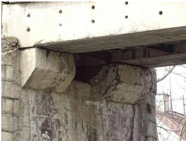
Úložné konzoly podpěry P2 v poli 2.
