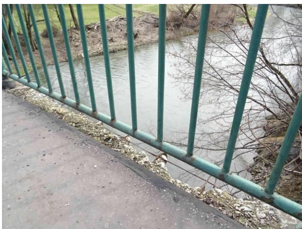
Rozpad betonu pravé římsy
