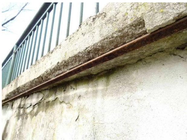
Podhled římsy nad OP1 vpravo. V okapním nose byl ponechán bednicí ocelový úhelník – koroduje
