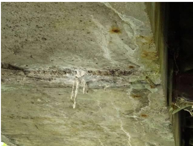
Detail foto výše – inkrustace ve spáře mezi segmenty
