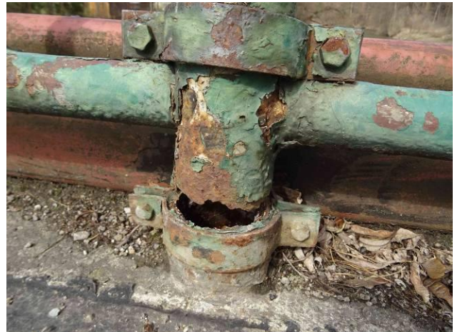
Detail foto vedle - urezlý sloupek zábradlí.
