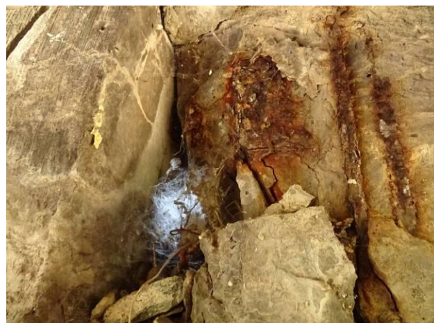
Detail foto výše – obnažená kotva předpětí.
