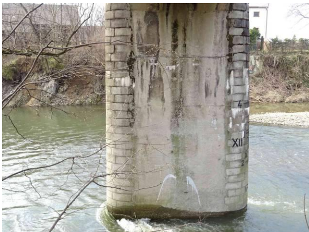
Podpěra P3. Průsaky , výluhy na povrchu.
