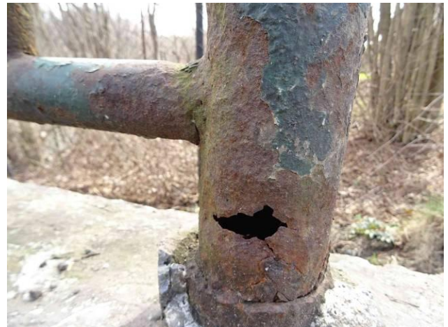
Prokorodovaný sloupek zábradlí
