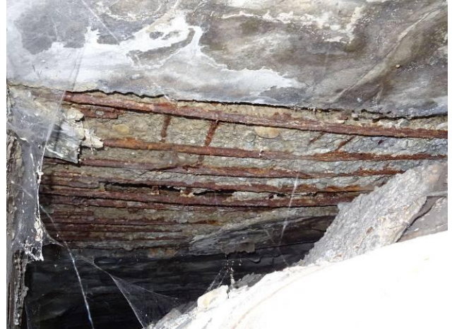
Celoplošně odpadá krycí vrstva betonových desek mostovky. Obnažená výztuž je laminárně zkorodovaná a jeví se prověšená.
