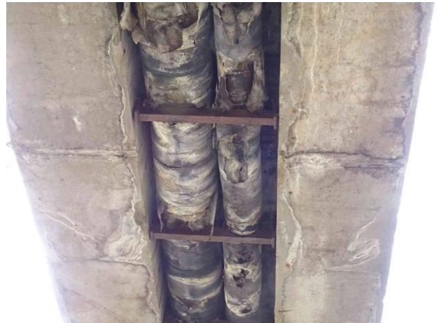
Podhled NK v poli 3. Stopy po zatékání na plochách nosníků z mostovky.
