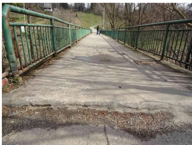
Vozovka před lávkou (nad OP1). Výšková nerovnost 50-60 mm, předmostí je pokleslé.
