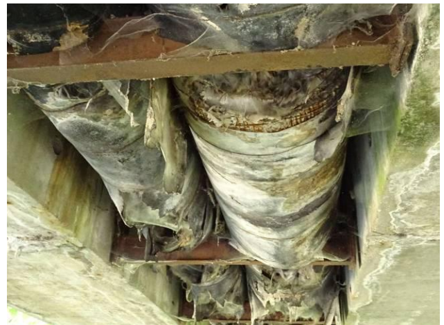
Zdevastovaný stav izolace trubních vedení v NK
