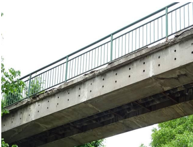
NK pole2 vpravo – rozpad betonu římsy
