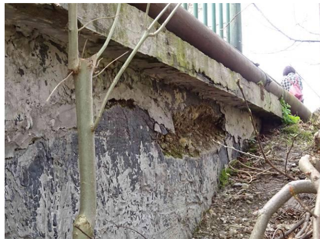
Křídlo K1L – rozpad betonu, kaverna
