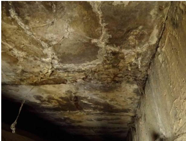
Betonové desky mostovky nad nOP1 – Průsaky, inkrustace, rozpad krycí vrstvy betonu
