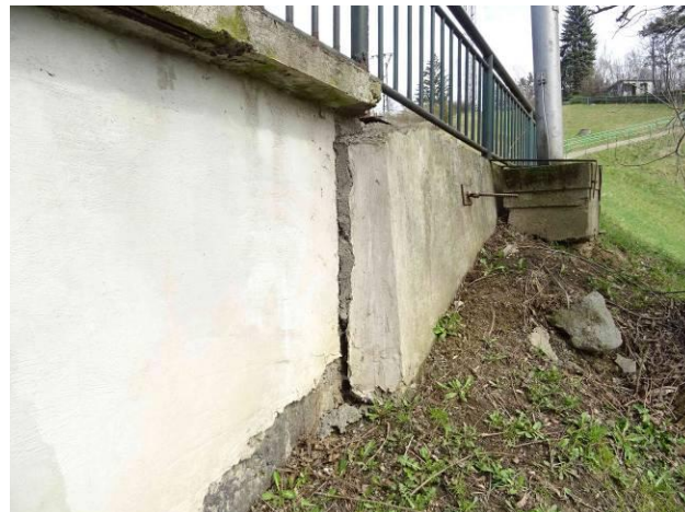
Opěrná zeď (OZ) navazující na křídlo K4P. OZ se vyklonila, byla zajištěna ocelovým táhlem. Foto 03/2021. Srovnáním s foto níže – setrvalý stav.
