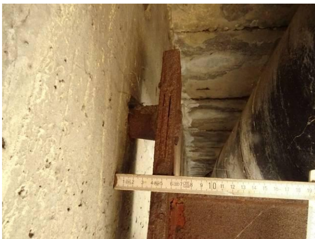
Ocelová konstrukce, na kterou jsou uložena potrubí, je vložena mezi nosníky a uložena přes čepy do otvorů příčného předpětí. Čep je vysunutý až 40 mm.
