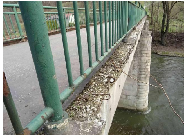
Dtto foto vedle – obnažené jsou třmínky
