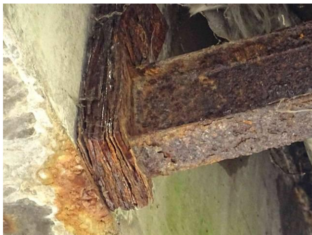
Ocelová konstrukce pro uložení trubních vedení. Masivní plátková koruze.
