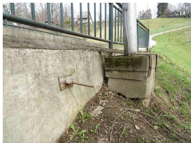
Základ stožáru VO za OP4 vpravo. Základ se naklání, byl zajištěn ocelovými pásy.
