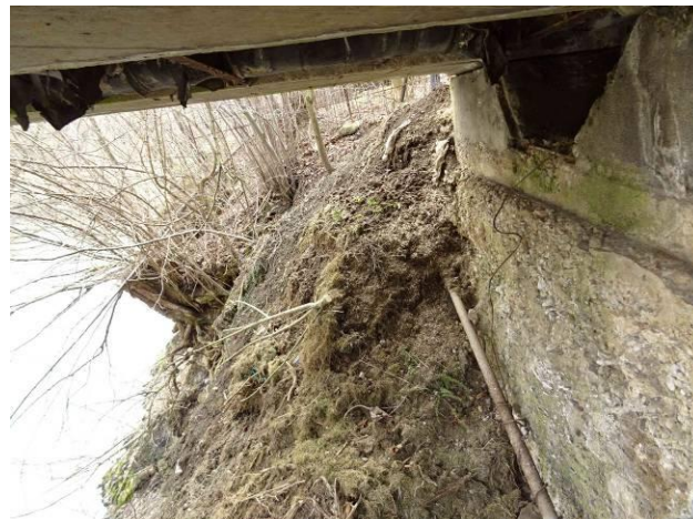
Spodní část OP1 – obnažená trubka chráničky.
