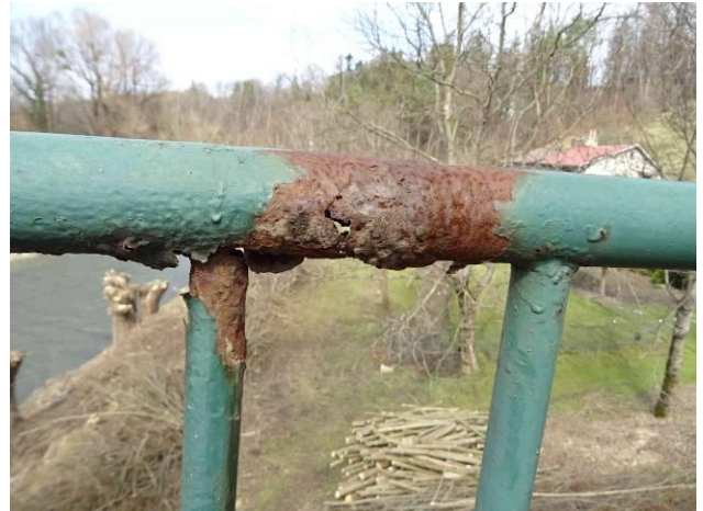
Prorezlé madlo zábradlí.
