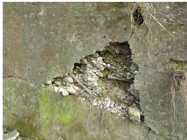
Detail foto výše – nesoudržný beton, tvorba kaverny
